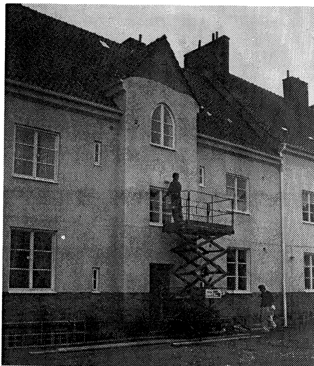
Kontinuerligt underhåll av husen förebygger skador som när de repareras kräver större förändringar av fasaden, t ex fönsterbyte och inklädnad i nytt fasadmateriäl
